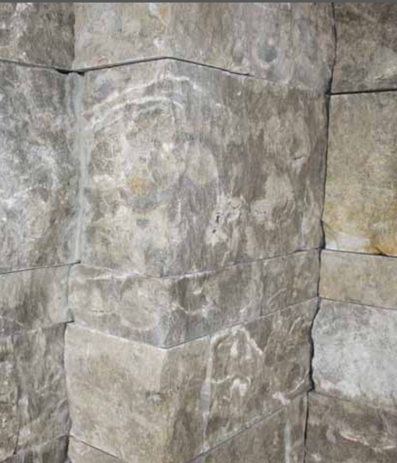
Pfraundorfer Dolomit, Mauerwerkecken
