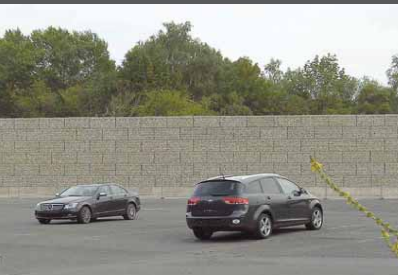
Sileno Plus, Lärmschutzwand, Pfraundorfer Dolomit, geschüttet
